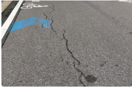
車道のひび割れが広がり穴になるとタイヤがパンクすることもあります。北栄2丁目にて撮影
