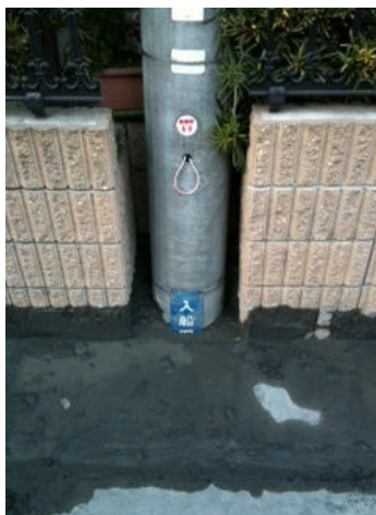
地中に沈み込んだ電柱
