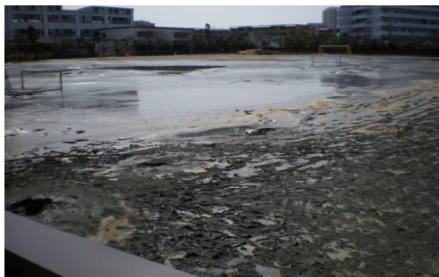
液状化した学校運動場
