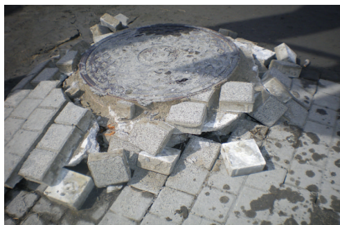
飛び出したマンホール
